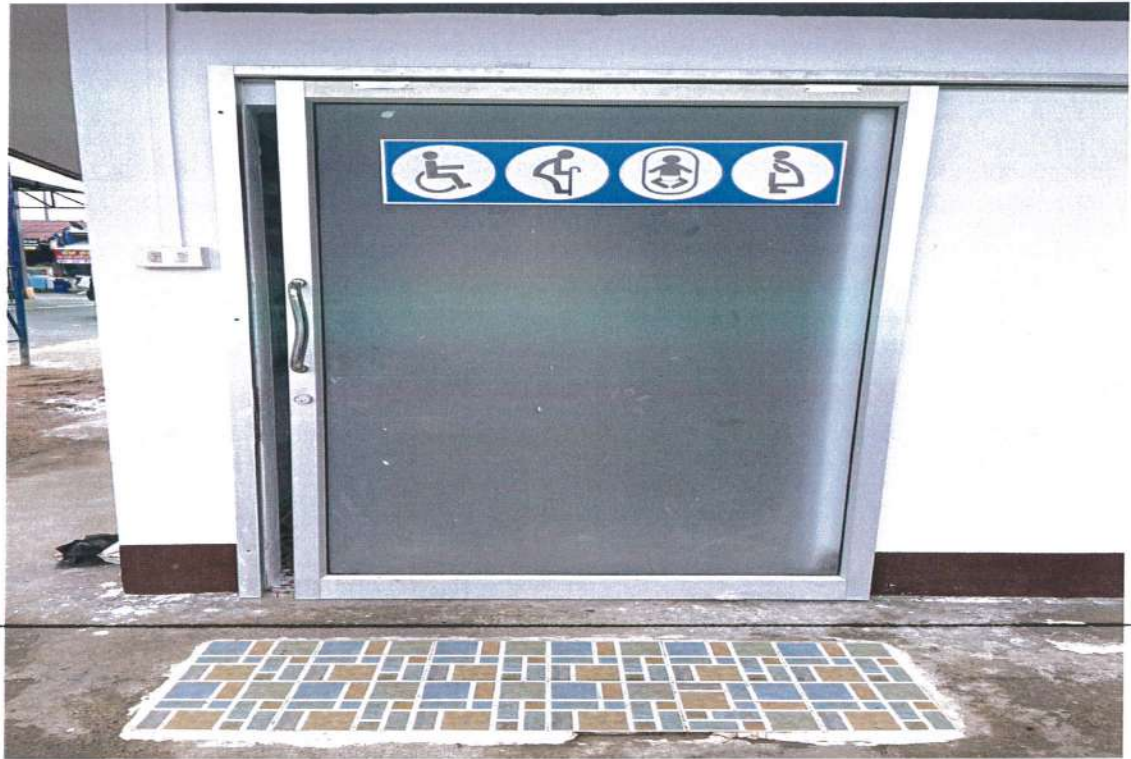
ห้องน้ำคนพิการ ตลาดสดบ้านใน
